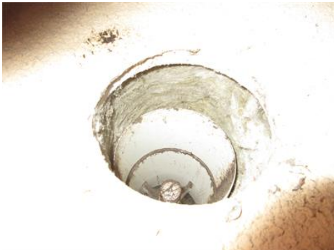
Ingen luftspalt i fasaden. Bild tagen via ventil i yttervägg
