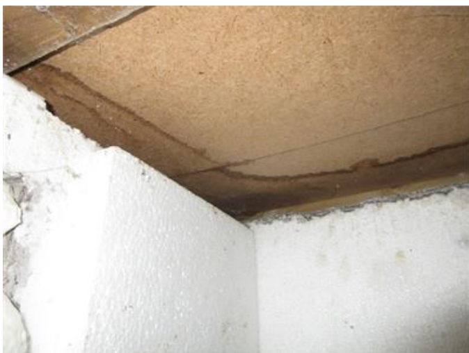
Exempel på missfärgningar undersida bjälklag vid grundmur
