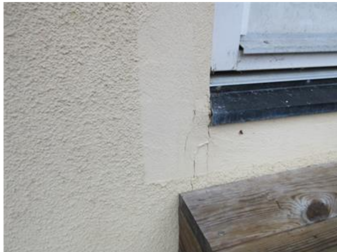
Sprickor i puts under altandörr
