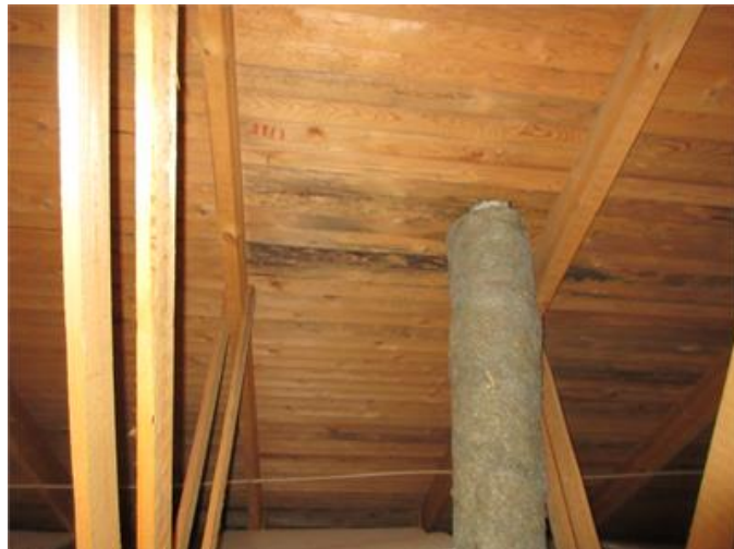
Exempel på missfärgningar/påväxt i vind
